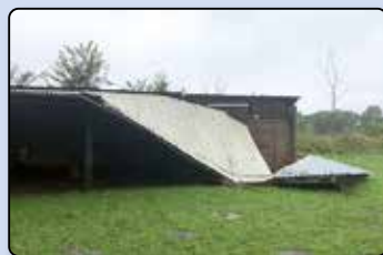
„Dach“-Schaden beim RRV Ellund
