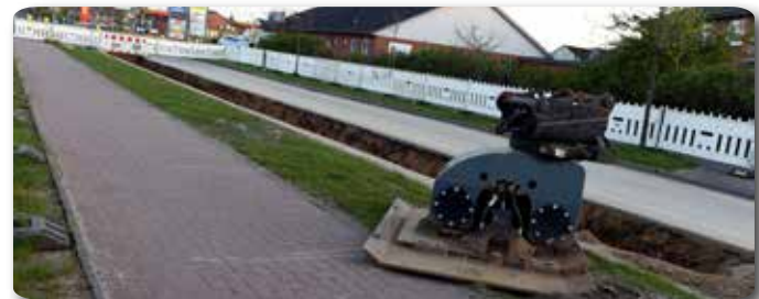
oben: Die Vollsperrung in der Raiffeisenstraße
