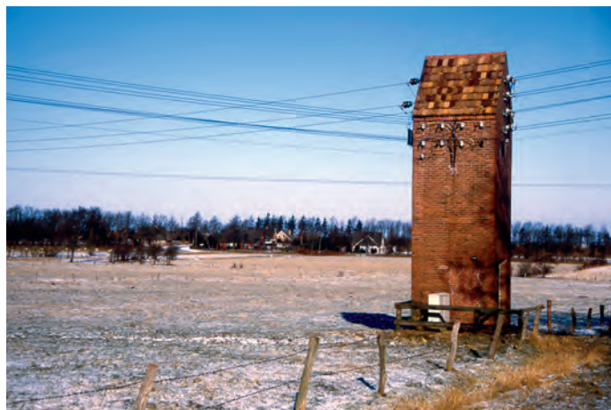
Gebäude-Trafostation nördlich der Dorfstraße Nr. 19 im Jahr 1987. Diese versorgte über 60 Jahre unseren Dorfkern mit elektrischer Energie.
